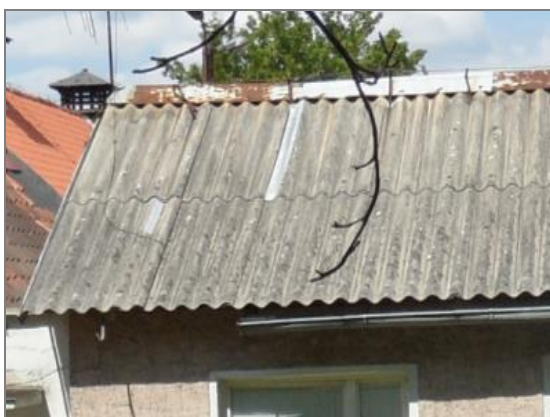
Fot. 1 Płyty azbestowo-cementowe faliste
