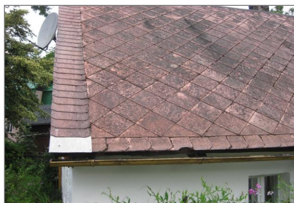
Fot. 2 Płyty azbestowo-cementowe płaskie
